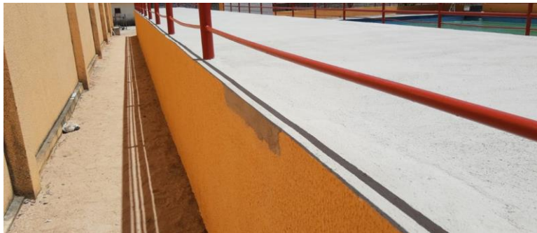
Figura 3: correção de pintura nas arquibancadas da piscina.
